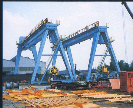
橋形クレーン
