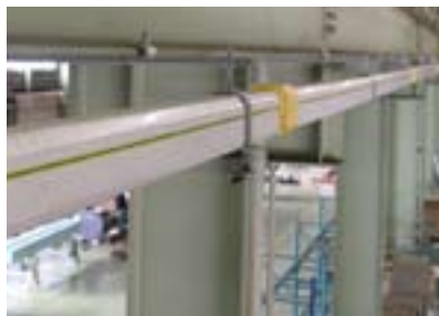
走行給電施工例
